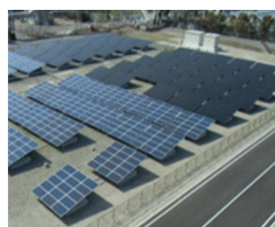
三井化学茂原分工場内の 「太陽光発電実証設備」
