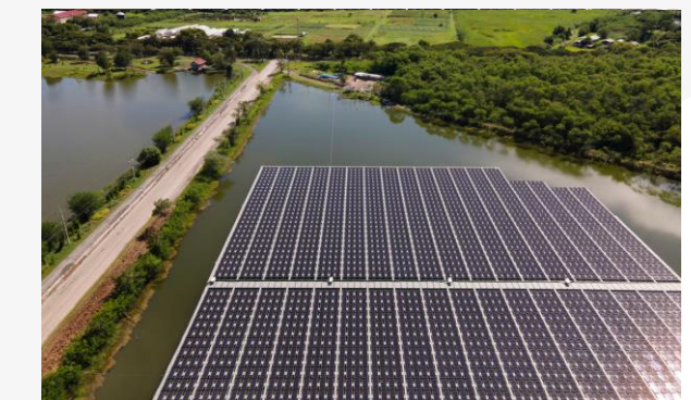
Pembangkit Listrik Tenaga Surya
