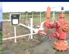
Kampung Baru Production Well
