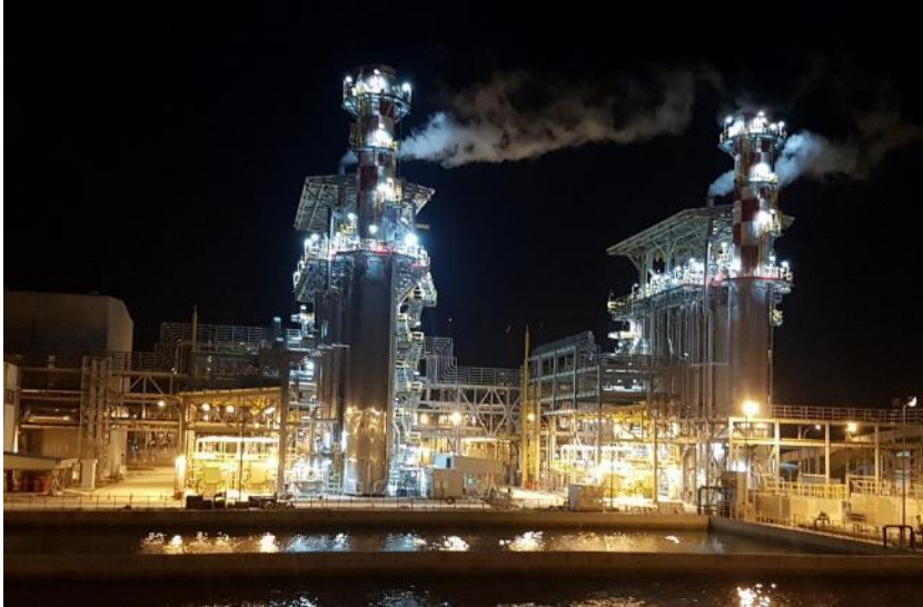
Riau-1 CCPP 275 MW
