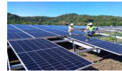
Sumbawa PV 26 MWp
