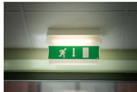
Pomiar oświetlenia awaryjnego i ewakuacyjnego
