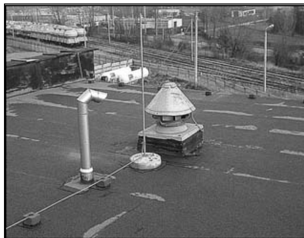
Obiekt przemysłowy zwód pionowy odsunięty
