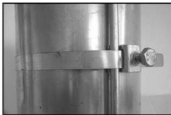
Przewód odprowadzający na rynnie
