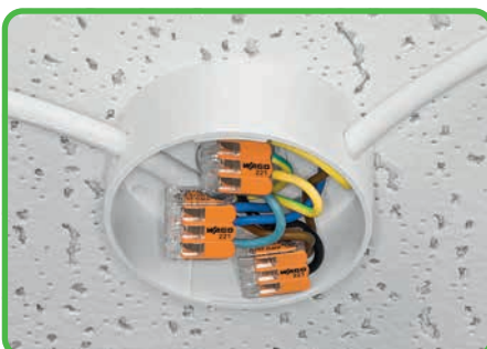
Puszka rozdzielcza do zasilania oświetlenia sufitowego
