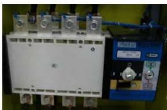
Szafa rozdzielcza ATS
