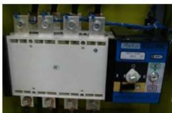
Szafa rozdzielcza ATS
