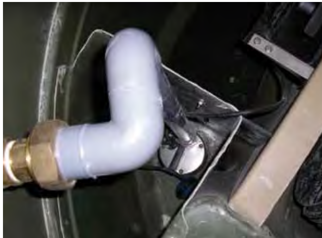
Miejsce montażu pompy
