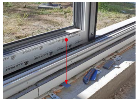
Zdjęcie nr 21 – niezalecane zastosowanie podkładek plastikowych
