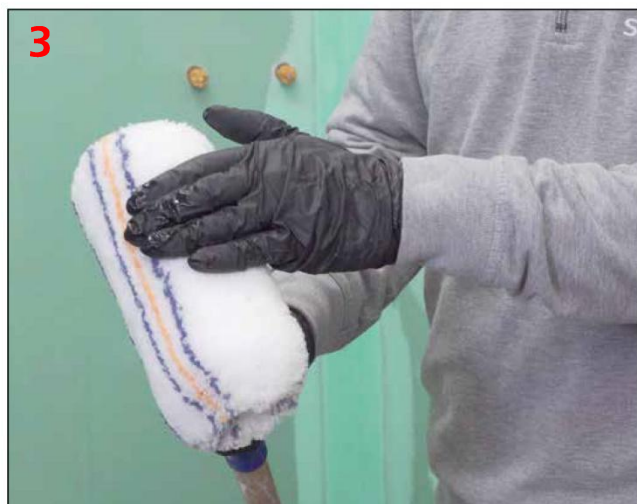
Dla szybkiego postępu prac zalecamy stosować wałek z owczej wełny.
