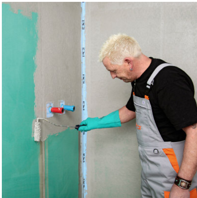
Nalożenie (z pełnym pokryciem podłoża) warstwy izolacji PCI Lastogum® szary na pozostałej powierzchni jednoczesnym przesmarowaniem brzo- gów taśm i manszet.
