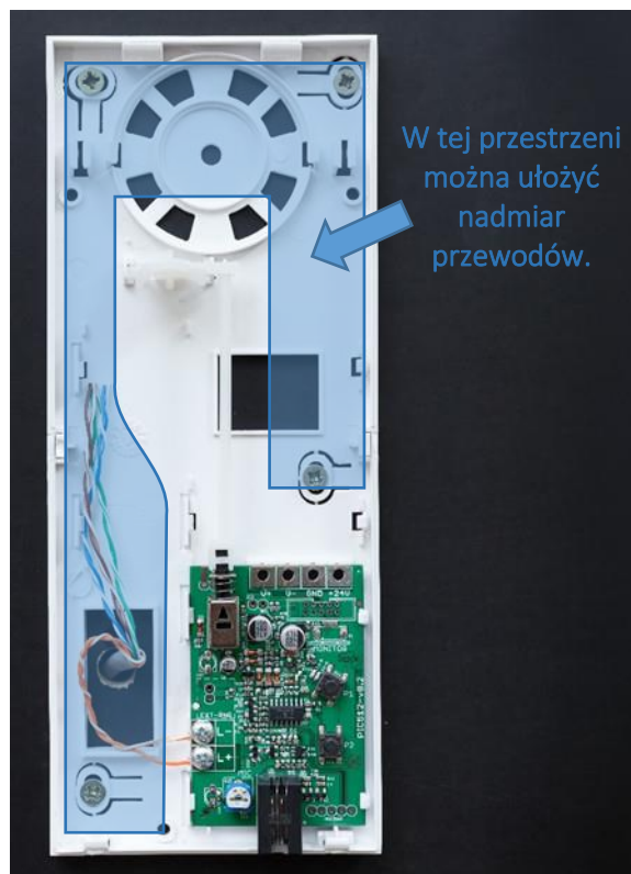
Fot. 9 Poprawnie podłączone okablowanie.
