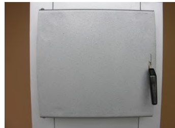
Fot.12. Widok drzwiczek przestawionych.
