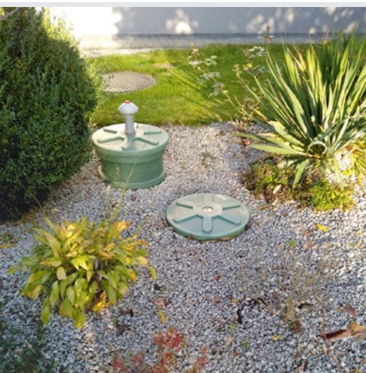
Skrzynka techniczna i pokrywa zbiornika
