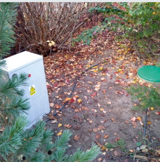
Skrzynka techniczna i pokrywa zbiornika
