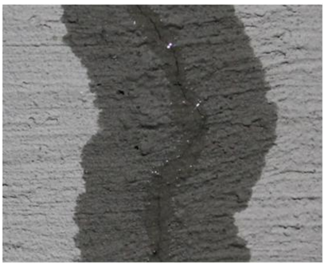
Fot. 2. Stopniowe zawilgocenie powłoki izolacyjnej w miejscu pojawienia się rysy.
