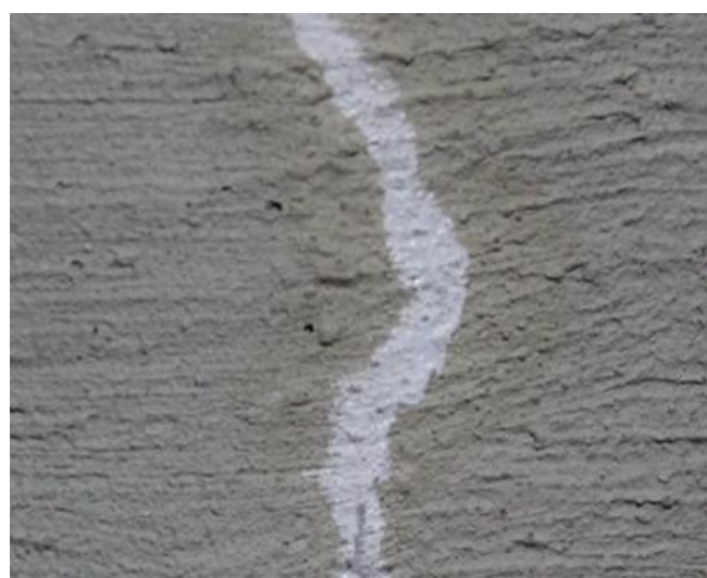
Fot. 4. Zamknięcie rysy przez kryształy soli, brak sączenia. Efekt po 21 dniach.
