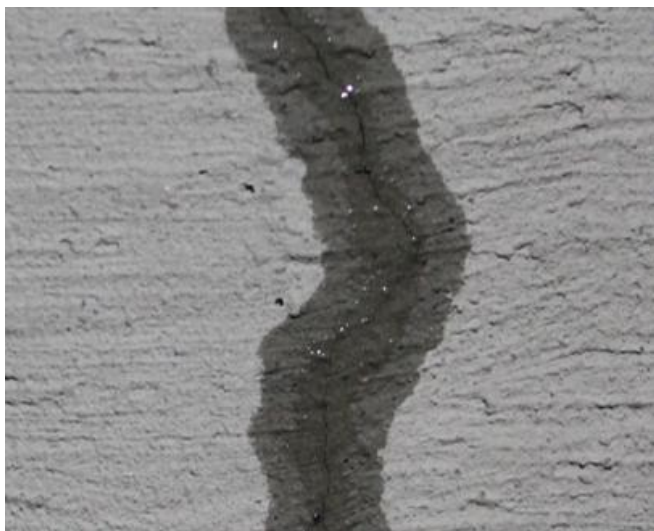
Fot. 1. Powłoka izolacyjna z ATLAS WODER SX na powierzchni betonu – napór wody od środka. Aktywny przeciek w miejscu wystąpienia rysy w podłożu.
