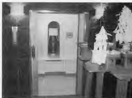
火葬炉左側に設置した高さ2m幅1mの粉骨機。
