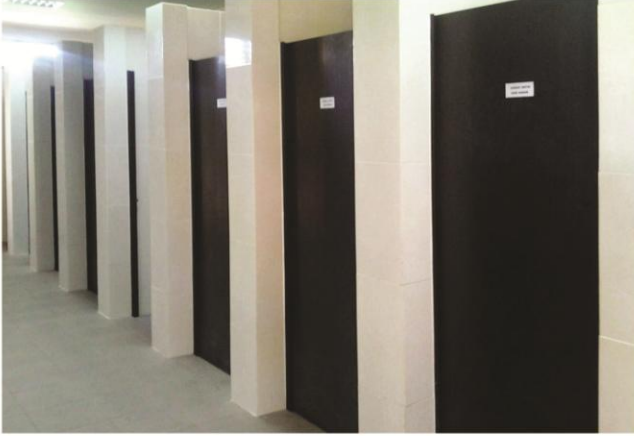
Pintu uPVC Kamar Ganti Wanita.
