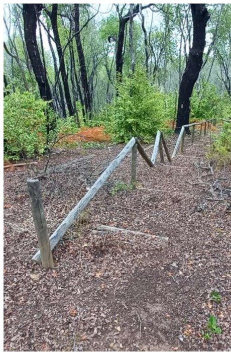
Foto 31. Pasamanos en mal estado.
