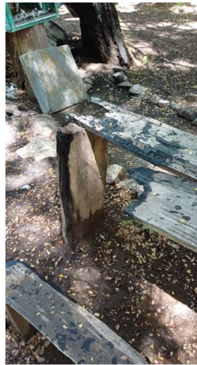
Foto 26. Evidencia de mesón con daño de fuego.
