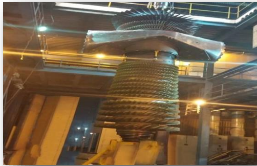
Siemens -138 MW Gas Turbine Paguthan
