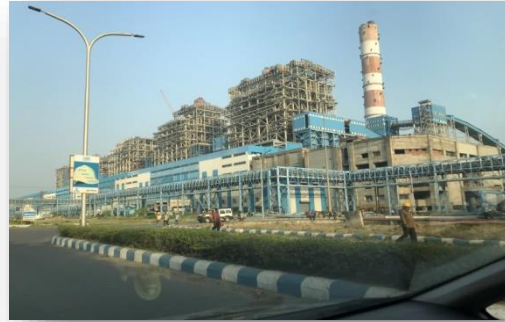
3x660 MW Barh STPP, NTPC
