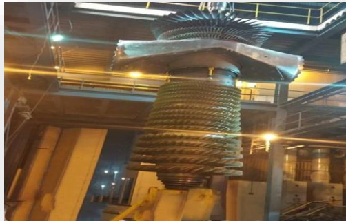
Siemens -138 MW Gas Turbine Paguthan
