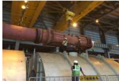
TURBINE AOH, 600 MW UDIPI
