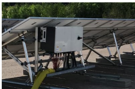
Aurinkopaneelien alle sijoitettavat invertteritelineet
