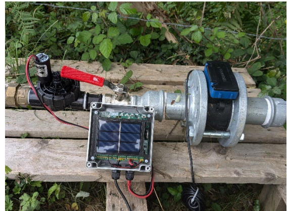
↑ Control de riego a una pequeña parcela con acometida en DN50 y caudal máximo 40 m 3 /h.
