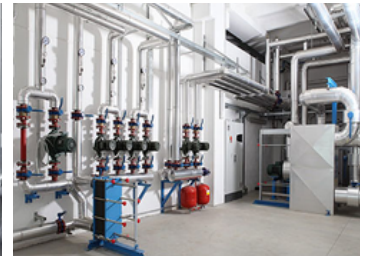
Site, Şehir Isıtma Uygulamaları
