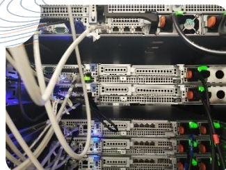
Réseau, cybersécurité et accès à distance
