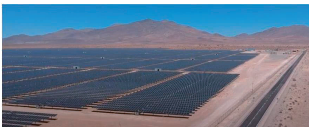
#5035 - PV El Pelicano, 110 MWp / 100 MW, La Higuera, Coquimbo region.
