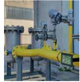
IMPIANTI PER H 2 , IMPIANTI MISCELAZIONE CH 4 /H 2 H 2 SKID, CH 4 /H 2 BLENDED STATIONS
