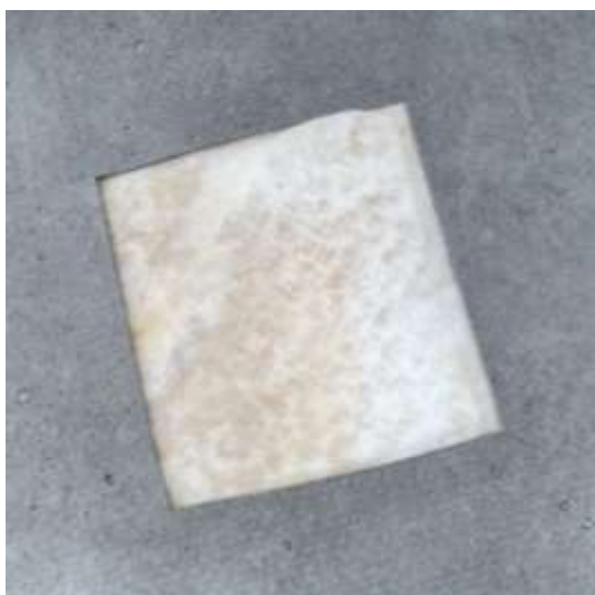
Řez provedený pod popraskaným tmelem.
