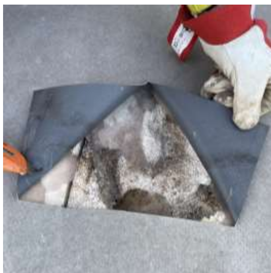
Pošlapem zjištěna degradovaná izolace. Po otevření pláště zjištěn výskyt myší a jimi prokousaných cestíček. Zároveň prokousané skelné rouno.
