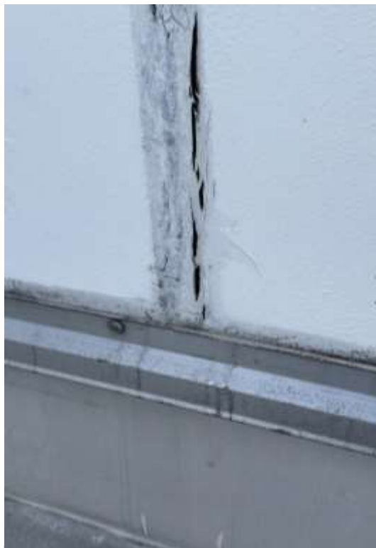
Popraskaný tmel nad opečkováním
