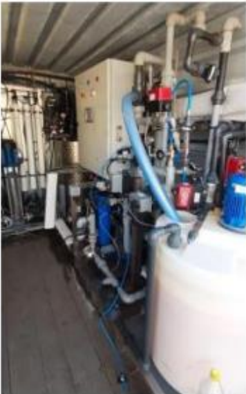
Figure 3 : Intérieur du container - carters d'ultrafiltration
