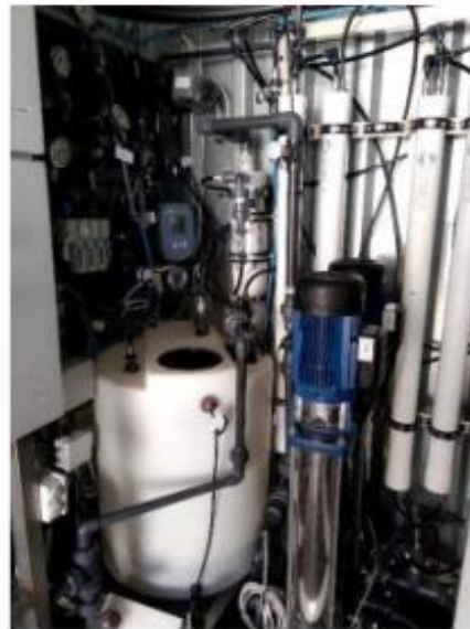
Figure 4 : Intérieur du pilote - Passes d'osmose inverse et bac de rejet
