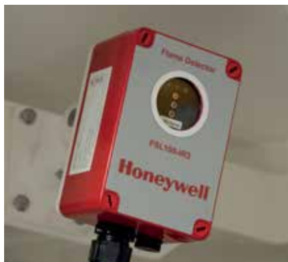
Rilevatore fiamma Flame detector
