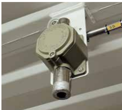
Rilevatore fughe gas Gas detector
