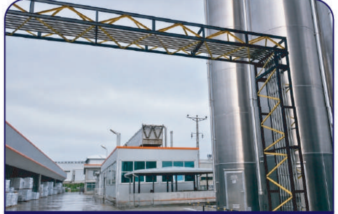
PVC GRANÜR TAŞIMA HATTI (KÖPRÜ GEÇİŞİ) PVC GRANULE CONVEYING LINE (BRIDGE CROSSING)
