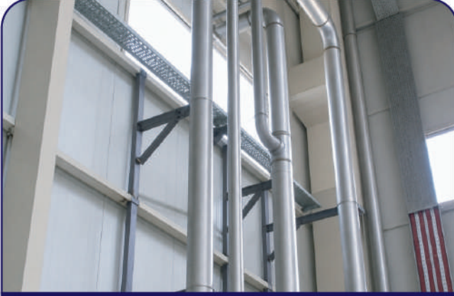
ENJEKSİYON SOĞUTMA ANA KOLLEKTÖR INJECTION COOLING WATER MAIN MANIFOLD
