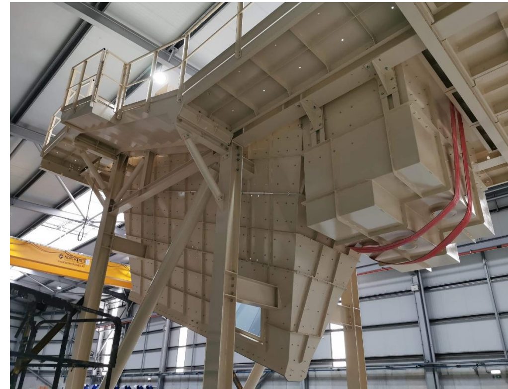
PROJECT: Estação de Crivagem e Britagem PLACE: Portugal
