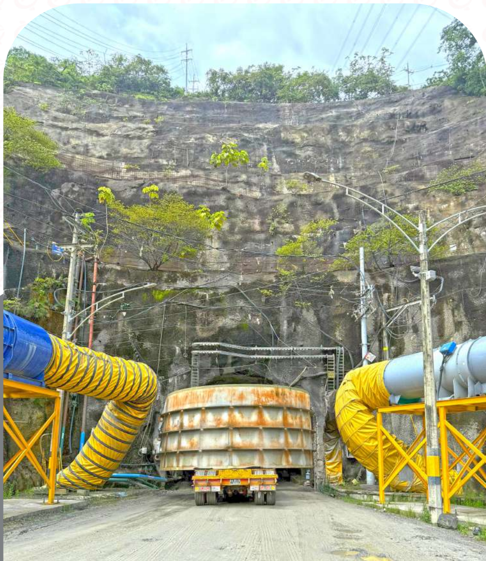
EPM Central hidroeléctrica de Ituango (Hidroituango) 2400 MW Trabajos mecánicos empotrados unidades 1 - 4 y 5 - 8 Ituango, Antioquia
