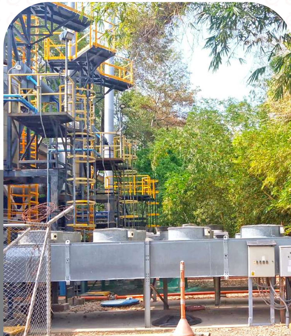
UTGC Centro de Generación Cantagallo Cantagallo Bolívar, capacidad instalada 3.856kW.
