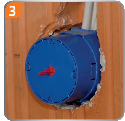
3 Deckel steht noch ca. 2,5 - 3 cm vor.
