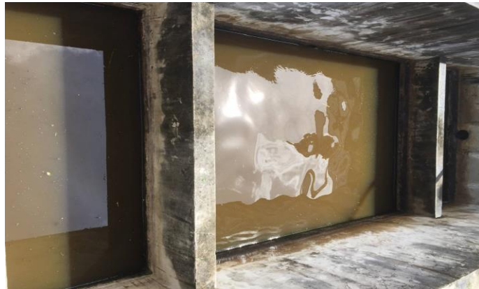
ภาพที่ ๖ บ่อบำบัดน้ำเสีย
