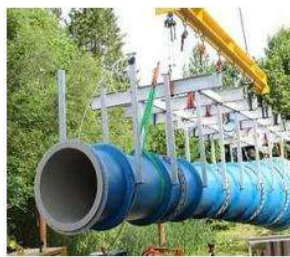
(d) Venturi turbine
