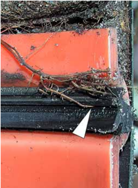
Abb.4: Einwurzelung in eine Rohrverbindung. Das Dichtelement dieser korrekt installierten Verbindung wurde von einer etwa 1 mm dünnen Weidenwurzel unterwandert.
