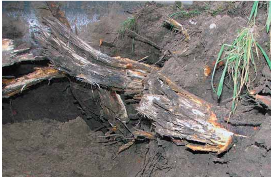
Abb.5: Unsachgemäßes Arbeiten bei Aufgrabungen im Bereich von Leitungsgräben führt häufig zu Wurzelverletzungen, welche betroffene Bäume in ihrer Existenz gefährden können. | Foto: Heiko Schmiedener
