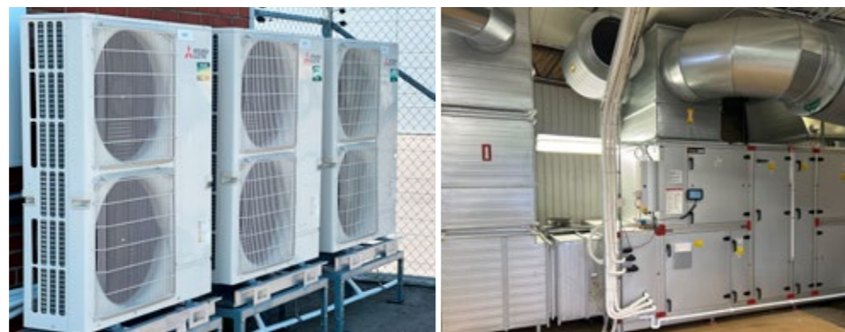
Värmepumpar på utsidan och FTX-aggregat på insidan som styr ventilationen.
