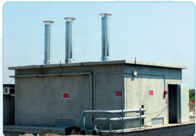
Central térmica de 3 calderas de una potencia total de 750.000 kcal/h. Hot water unit of 3 burners for a total power of 750.000 kcal/h.
