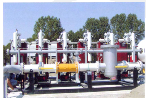
1ª etapa, 6.000 kg/h de capacidad con medida en línea. 1 st stage, 6.000 kg/h capacity with metering line.
