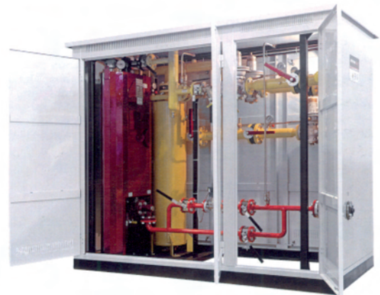
1ª etapa, de doble línea 1.000 kg/h de capacidad con colector de condensado 1 st stage, double line 1.000 kg/h capacity with condensate trap.
