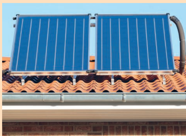
Coletor solar colocado sobre o telhado de uma residência.
