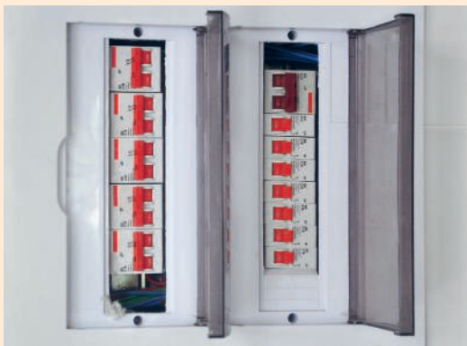
Caixa de distribuição de uma instalação elétrica.
