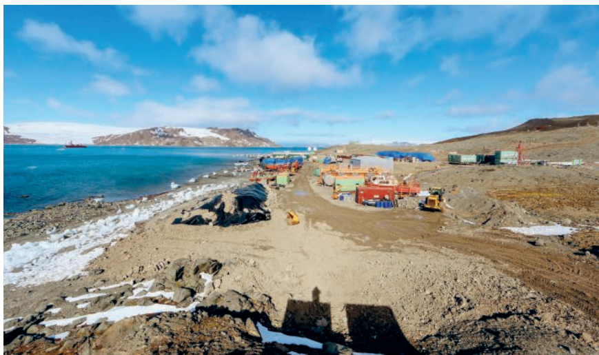
Obra de reconstrução da Estação Antártica Comandante Ferraz, em 2017, situada na ilha Rei George, no mesmo lugar em que funcionava a anterior.
