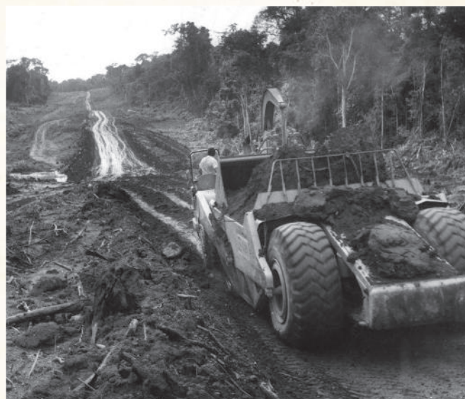
Trecho de construção da Rodovia Transamazônica, próximo a Altamira, no Pará. Foto de 1972.
