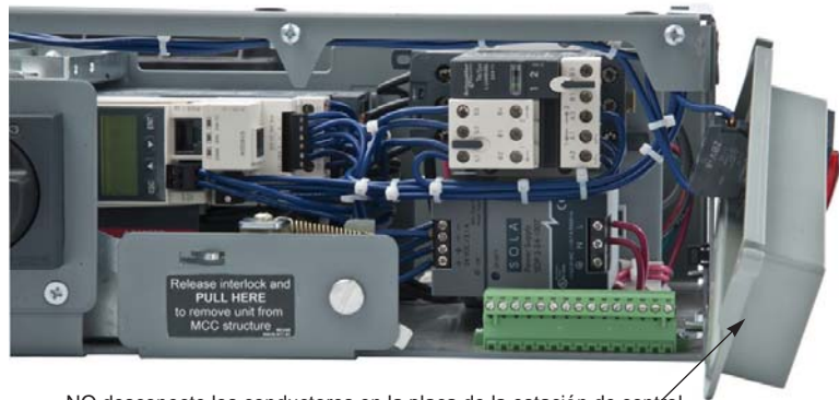
Figura 25: Placa de la estación de control (desmontada)
