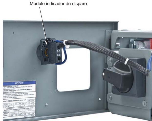
Figura 18: Módulo indicador de disparo (en la parte posterior de la puerta)
