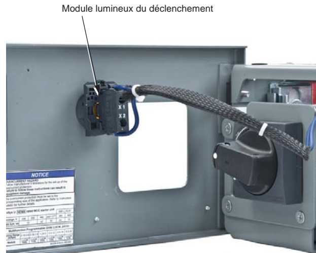
Figure 18: Module lumineux de déclenchement (arrière de la porte)
