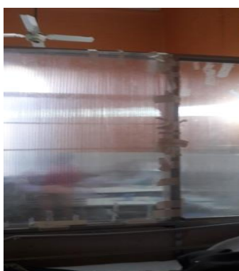
Falta de mantenimiento
