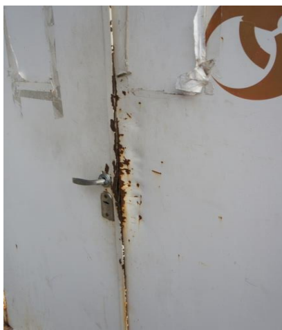
Rotura sobre la puerta del depósito.
