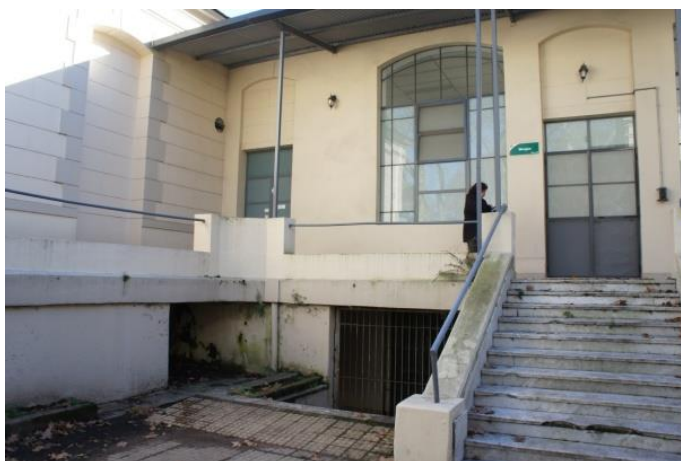
Inconveniente para acceder, depósito en altura.
