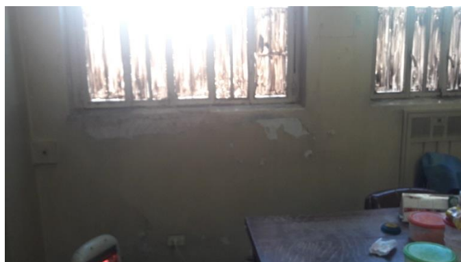
Filtración en área de cirugía
