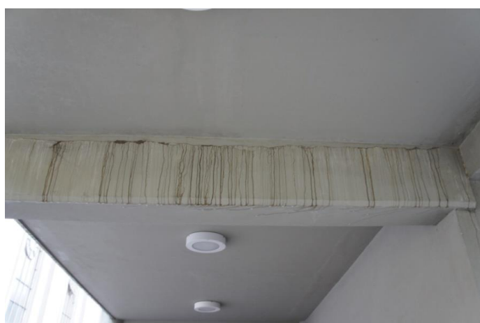
Rajadura y filtración de agua con goteras sobre viga.
