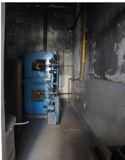
Sector de máquinas, detrás del depósito, con el mismo ingreso.
