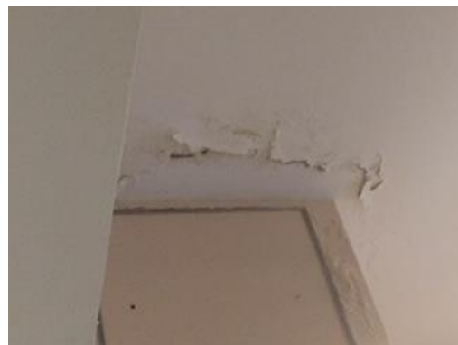
Humedades en cielorrasos
