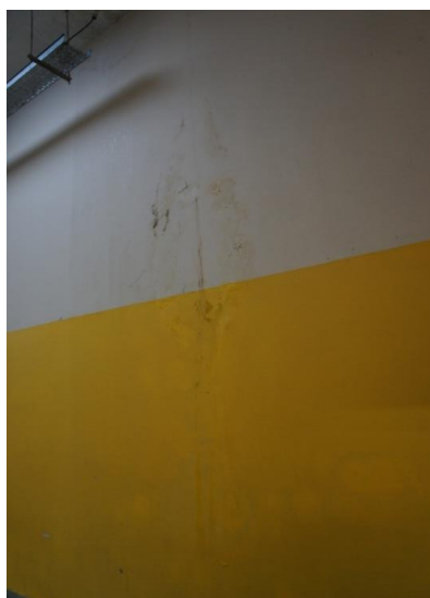
Manchas de humedad sobre muro por filtraciones.
