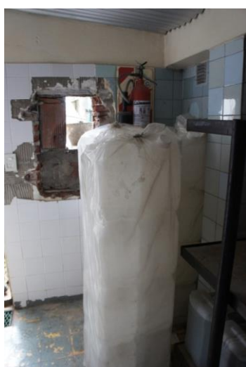
Se observan los paquetes de bidones sin uso, se aprecia el faltante de algunos azulejos.
