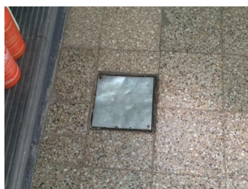
Rejillas sueltas en áreas cerradas
