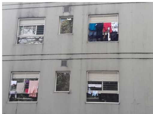
Falta de pintura exterior
