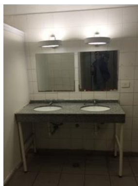
Falta de mantenimiento
