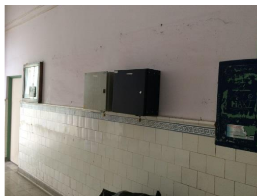
Áreas generales falta de pintura
