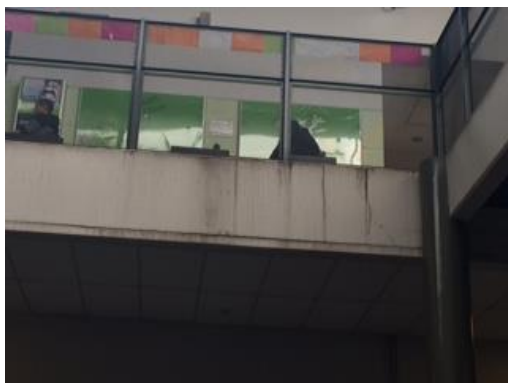
Falta de pintura y chorreaduras
