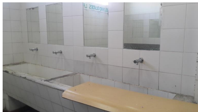
Baños sólo con agua fría
