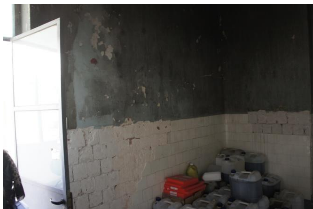
Se produce el desprendimiento del adhesivo y de los azulejos.
