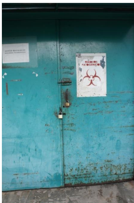
El acceso cuenta con una puerta de doble hoja metálica, debería ser pintada nuevamente.
