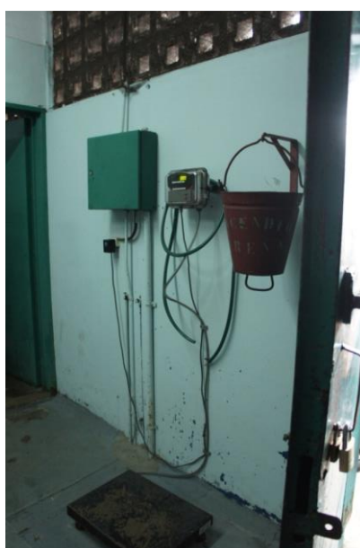
Lindante al acceso y sobre el muro, se ubica una balanza eléctrica.
