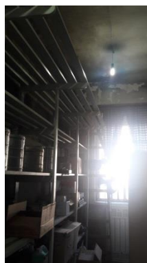
Filtración en área de cirugía
