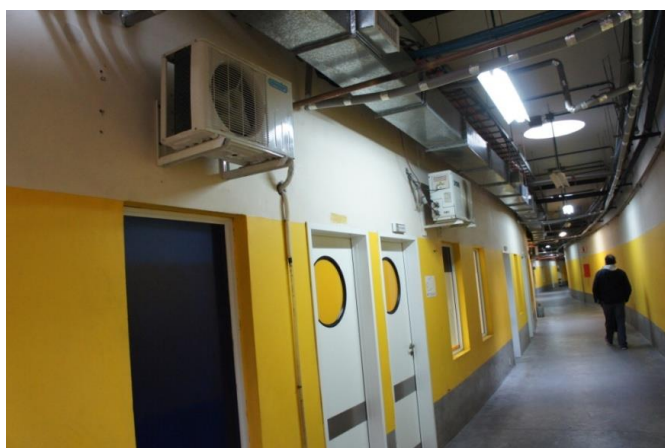
Aire acondicionado (Split) en pasillo interno.
