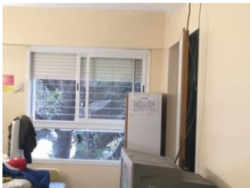
Ventanas abiertas en áreas que no corresponden
