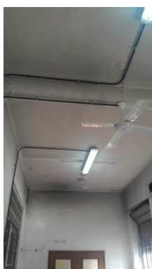
Humedades e instalación eléctrica exterior
