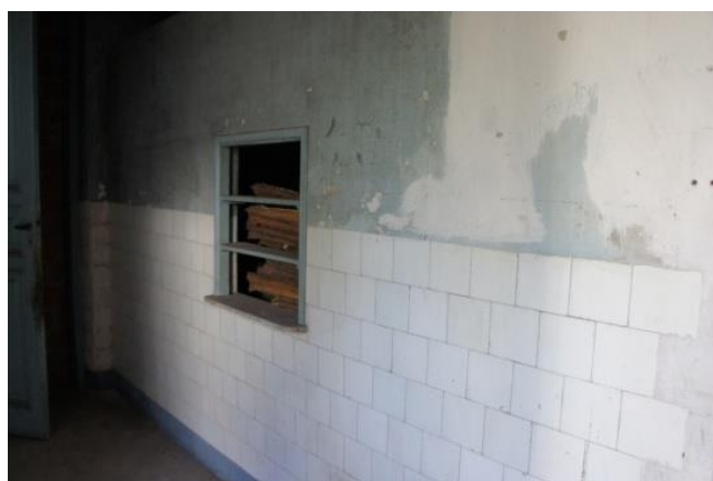
Se ubica previo a un sector de máquinas, dividido por un muro y con una ventana la cual fue tapada en forma precaria.
