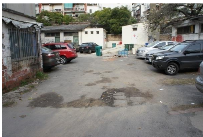
Rotura y deterioro de la calle de circulación interna.
