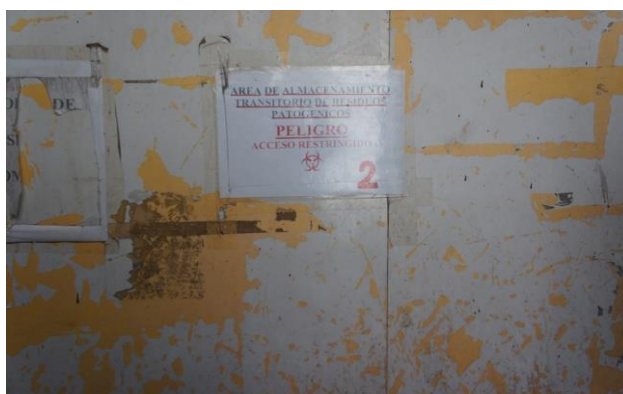
La señalización es inadecuada y poco legible.
