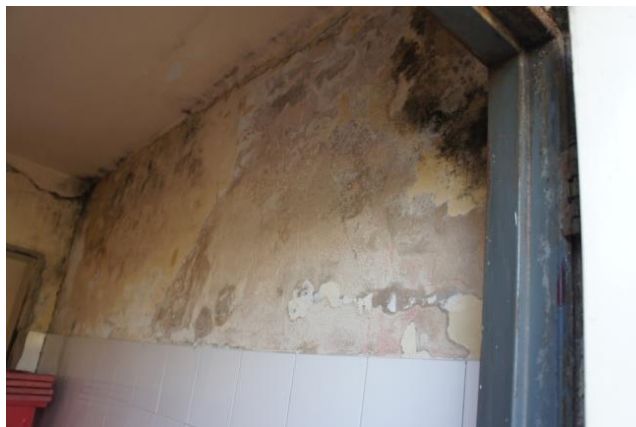
Desprendimiento de revoque sobre un lateral del sector.
