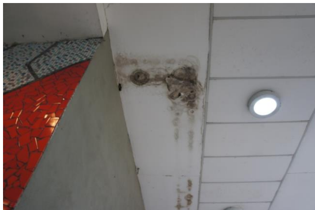
Manchas de humedad deterioro y descascamiento de la pintura.
