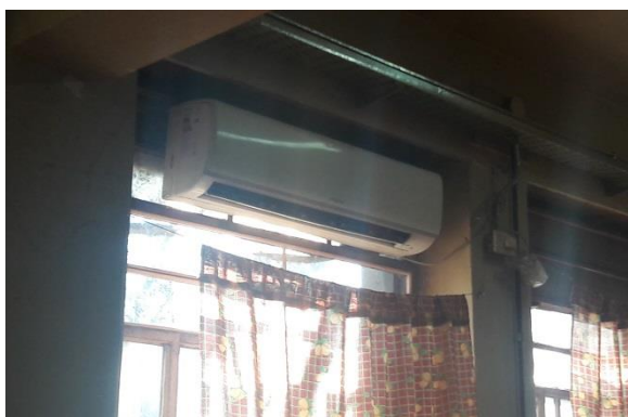
Equipos de aire para calefaccionar
