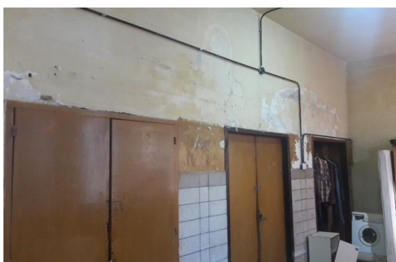
Humedades e instalación eléctrica exterior
