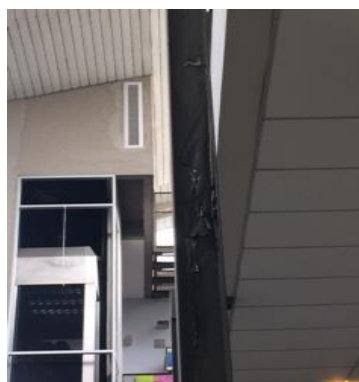
Falta de pintura
