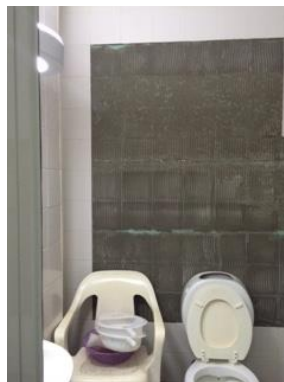
Baño de padres deteriorado
