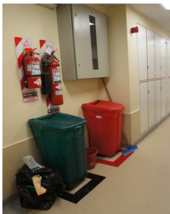
Sobre el pasillo de circulación se encuentran depósitos de almacenamiento transitorio.
