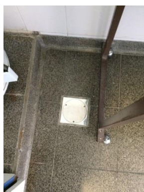
Rejillas correctamente cerradas
