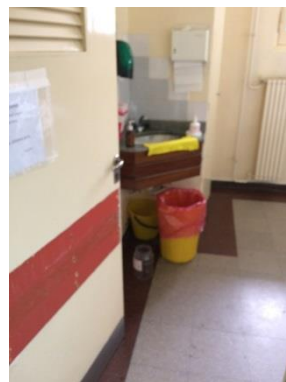
Falta de mantenimiento y pintura
