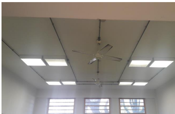
Humedades e instalación eléctrica exterior
