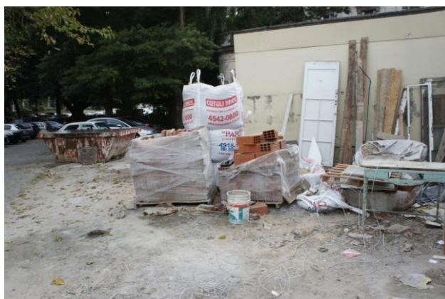
Acopio de materiales, desmantelamiento, herramientas desordenadas, suciedad dispersa y volquete alejado.
