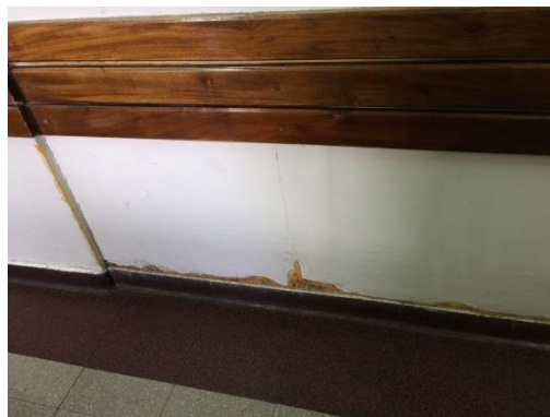
Falta de mantenimiento y pintura
