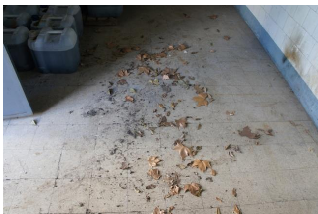
Se aprecia suciedad dentro del depósito.
