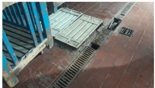
Regular estado de mantenimiento
