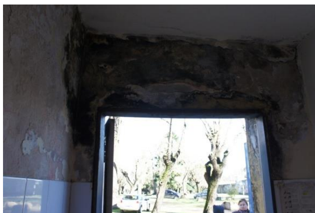
Manchas de humedad sobre el ingreso al sector.
