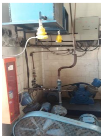
Compresores en lugares que no corresponden
