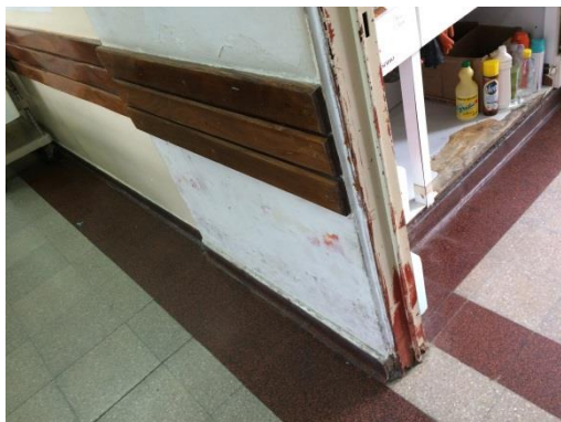
Falta de mantenimiento y pintura Muebles deteriorados
