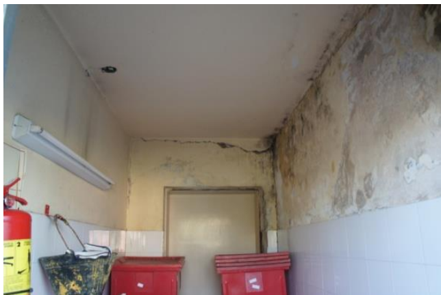
Grietas y descascamiento de la pintura dentro del depósito.
