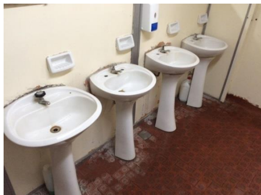
Falta de mantenimiento
