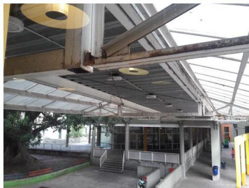
Falta de pintura estructura metálica
