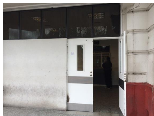
Puertas de seguridad
