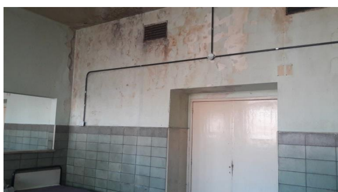
Humedades e instalación eléctrica exterior
