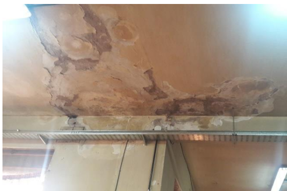
Humedades e instalación eléctrica exterior
