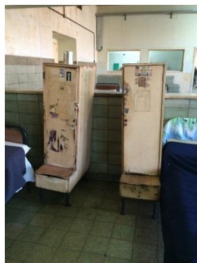
Estado regular del equipamiento
