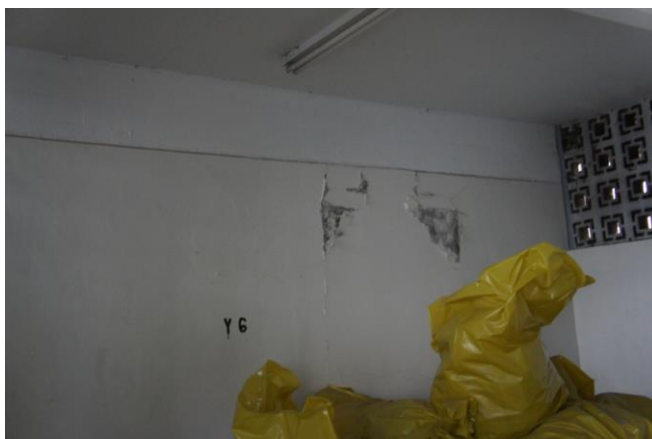
Se aprecia el desprendimiento de pintura sobre uno de los muros.
