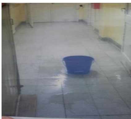
Goteras en acceso a quirófanos
