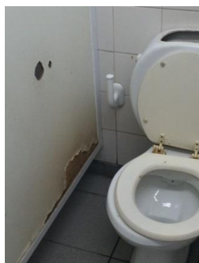
Falta de mantenimiento
