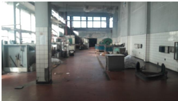
Regular estado de mantenimiento
