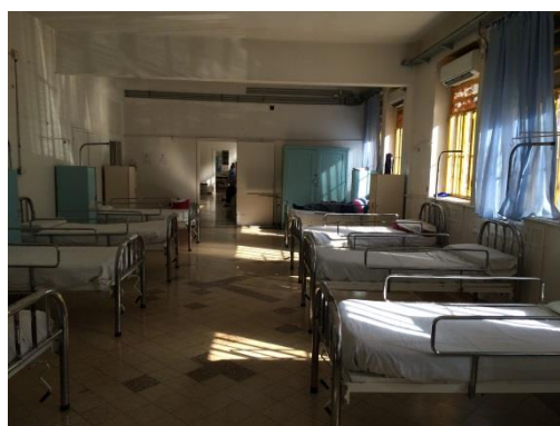
Filtración en área de cirugía
