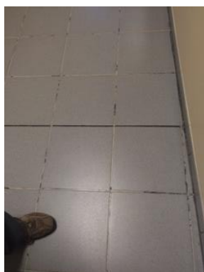
Juntas de cerámicas en mal estado
