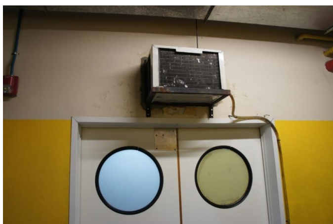
Aire acondicionado (de pared) en pasillo interno.
