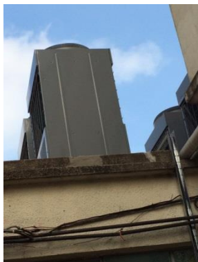
Torres de enfriamiento
