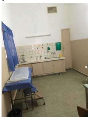
Filtración en área de cirugía
