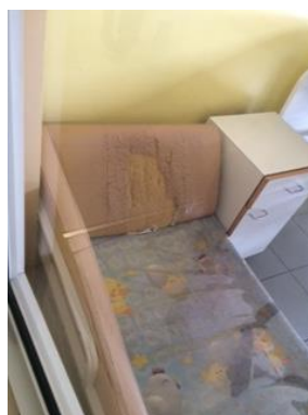
Camas acompañantes deterioradas
