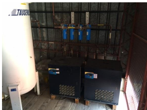
Nuevos equipos de filtrado de aire
