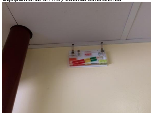
Sistema de control de oxígeno
