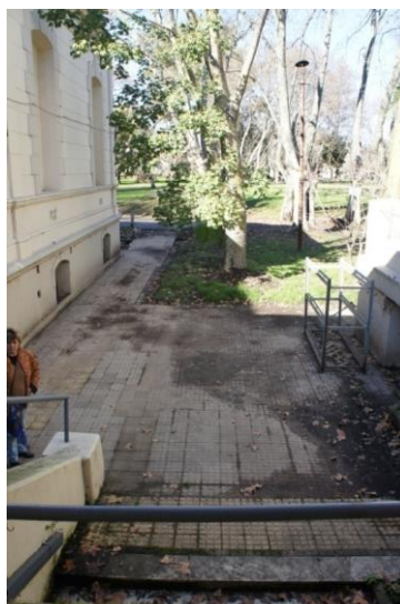
Rotura o deterioro en el solado, lo cual no produce problemas en la circulación.
