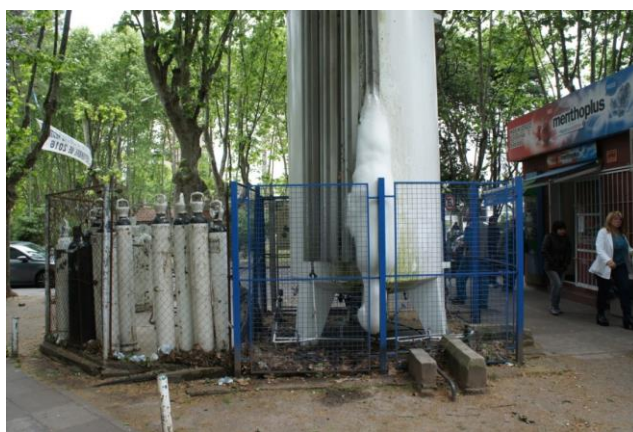
Se observa que por las cañerías del tanque central se ha condensado gran cantidad de hielo.
