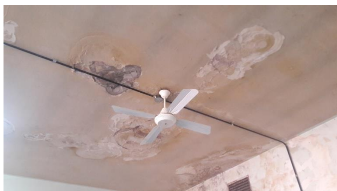
Humedades e instalación eléctrica exterior
