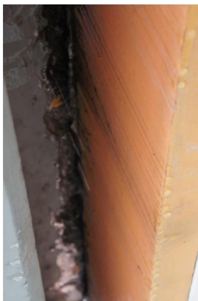
Rajadura y filtración de agua con goteras.
