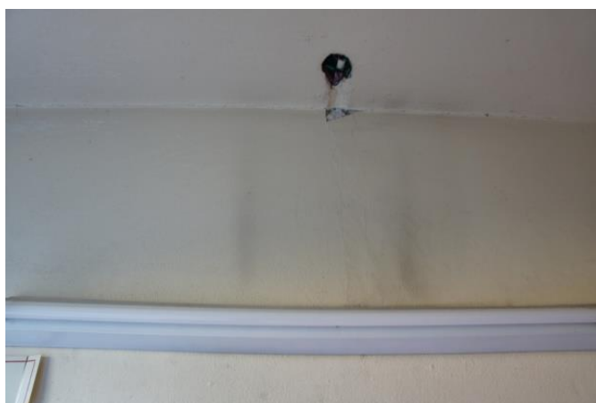
Caja distribuidora (electricidad), sin tapa y con sus cables a la vista.
