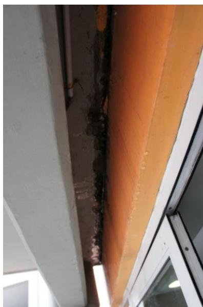
Rajadura sobre puerta de ingreso.
