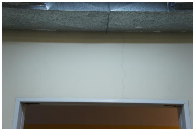
Rajadura en muro sobre abertura.
