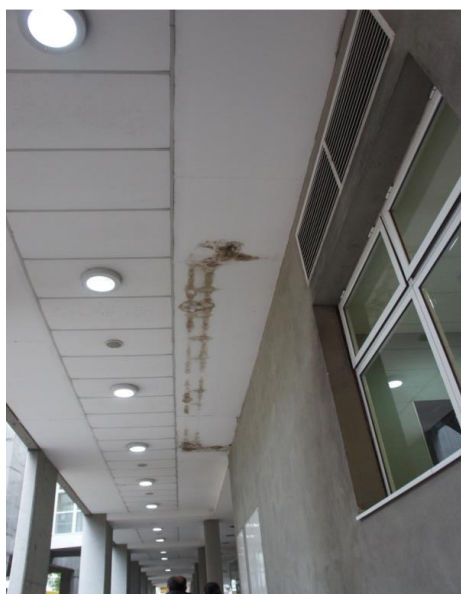
Manchas de humedad deterioro de la pintura.
