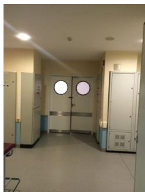
Acceso único con tableros eléctricos
