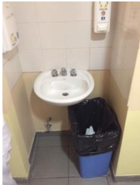
Grifería común en área estéril
