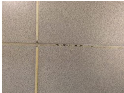
Juntas de cerámicas en mal estado
