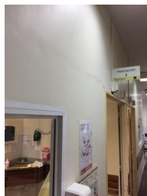
Fisuras en paredes
