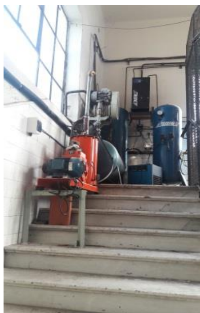
Compresores en lugares que no corresponden
