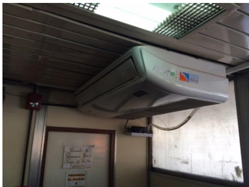
Equipos de aire individuales
