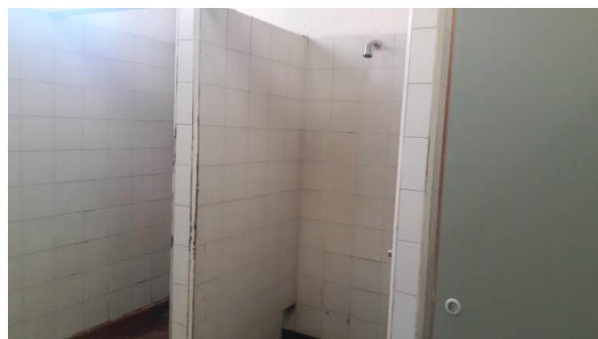
Baños en regular estado
