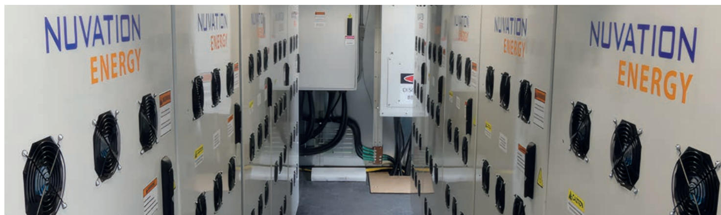
Il sistema di accumulo di energia sviluppato da Nuvation Energy in collaborazione con Analog Devices
