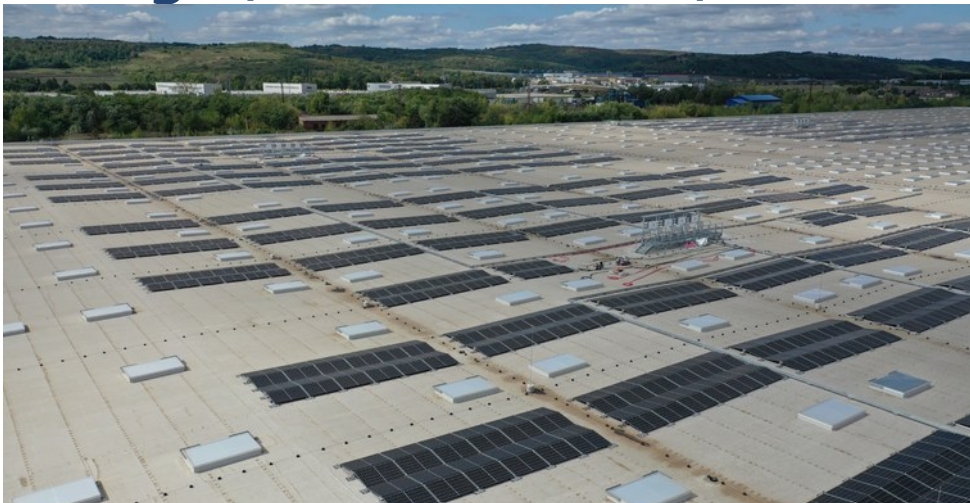
Tetőre telepített napelemrendszer
