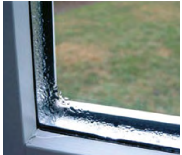
Kondensat im Randbereich der Innenscheibe
